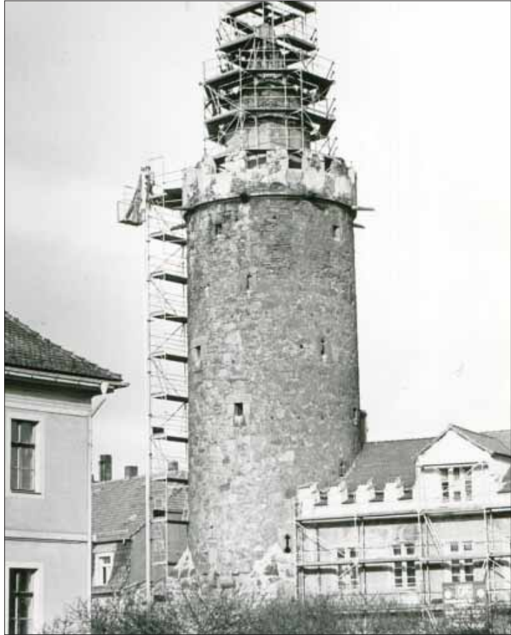
Zeitreise ins Jahr 1992: Ein Gerüst wurde für die Sanierung der Turmkrone aufgerichtet.
