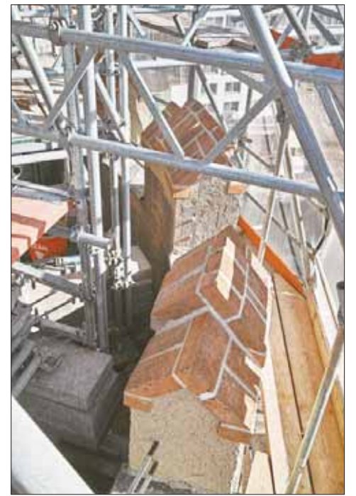
Eine neue Ziegelabdeckung schmückt nun den Zinnenring. Durch diese Form der Abdeckung ist das Abrutschen der Ziegel ausgeschlossen.
