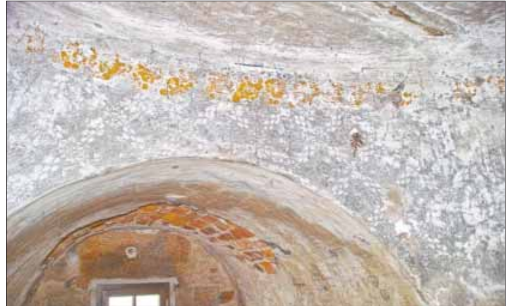
Reste der farblich gestalteten Ausmalung der einstigen Türmerwohnung kamen bei Sanierungen zum Vorschein.
