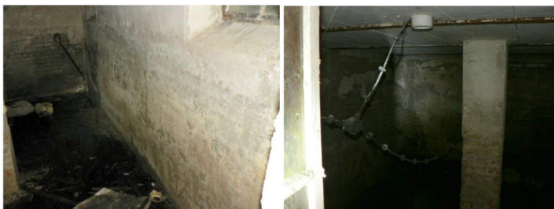
Abbildungen 6: der Kellerraum steht bis 20cm hoch unter Wasser
